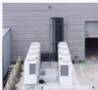
STEMCELL Technologies, ein global agierendes Biotechnologieunternehmen, nutzt CO 2 -Verflüssigungssätze in seinen Kühllagern, Frankreich. Kältetechnik
