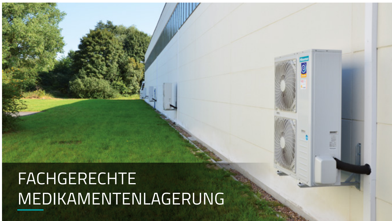
PAC-Außengeräte von Hisense zur Hallenklimatisierung platzsparend an der Fassade platziert
